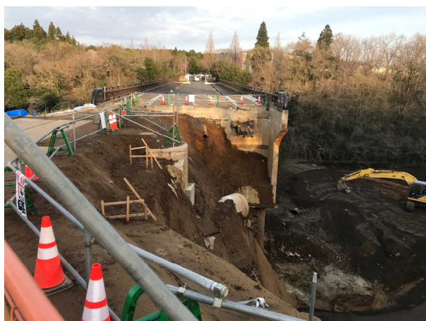
3月末現在の復旧状況
